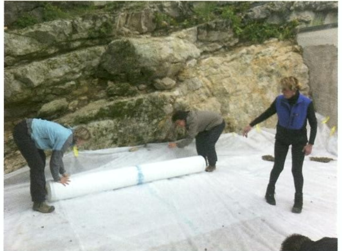
Strassenvlies wird zum Schutz vor der Mäuseinvasion eingelegt, bevor die Mergel-Humus-Kiesschicht eingefüllt wird (Verensarbeit)
